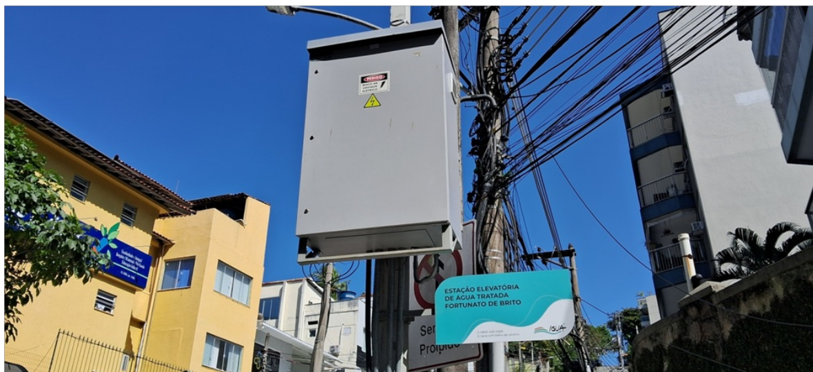
Foto 4 – Placa de identificação da estação e painel elétrico, que é protegido por para-raios.
