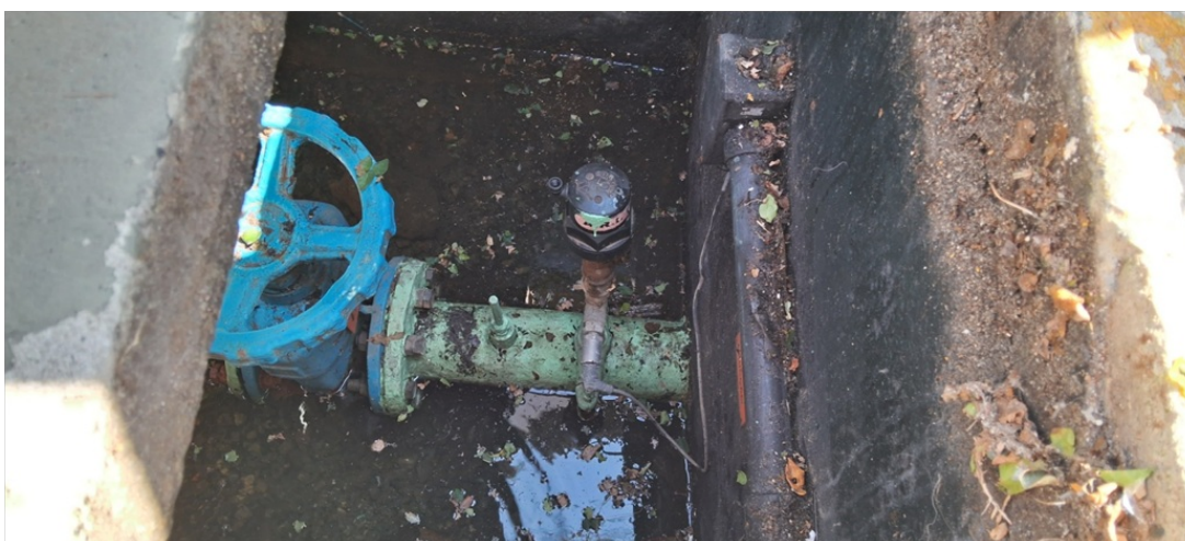
Foto 3 - Tubulação de sucção, dotada de ventosa e registro.
